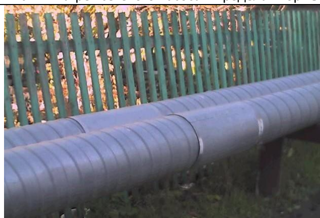
Рис. 5 – на поверхности теплотрассы потерь тепла не обнаружено.
