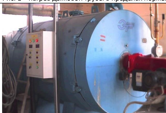
Рис. 2 – следы потерь тепла на поверхности котла.
