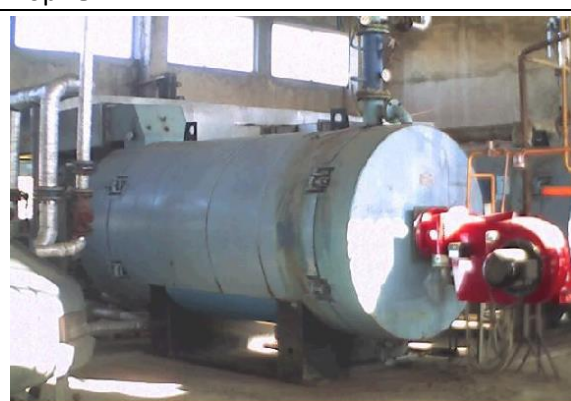
Рис. 2 – на поверхности котла и газохода присутствуют очаги перегрева.
