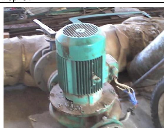
Рис. 5 – перегрев насоса котлового контура.
